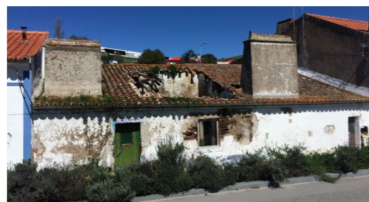
67 | Exemplo de edifício em Ruína
