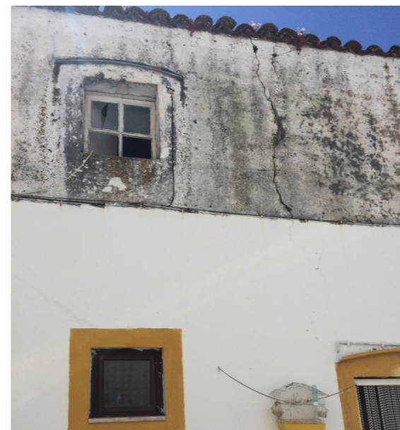
79 | Fachada com fissuras
