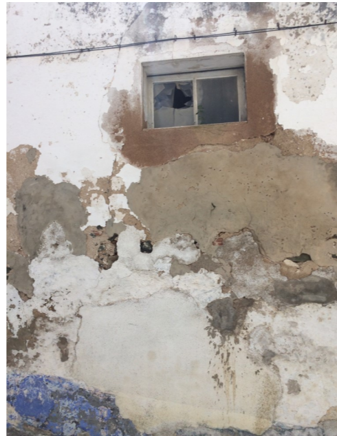
81 | Grave desagregação de argamassas
