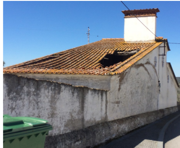
72 | Cobertura parcialmente colapsada
