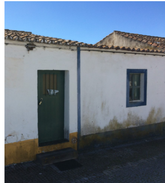
78 | Manchas e bolores nas fachadas
